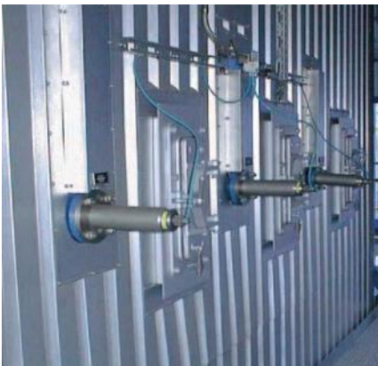
PKL 240 HT monteret på et stort filter ved et kraft- varmeværk
